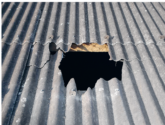
Fig. 8: Rupture de panneaux en fibrociment ondulés
